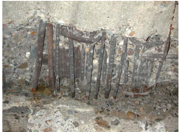
Durch Wasserhochdruckstrahlen freigelegte Bewehrung
